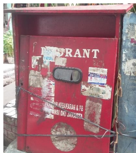
(2) Hidran yang sudah rusak di Kecamatan Tambora
