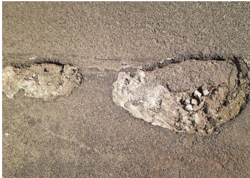
Gambar 7. Kondisi jalan berlubang
