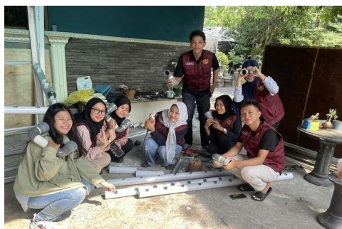
Gambar 1. Persiapan instalasi hidroponik
