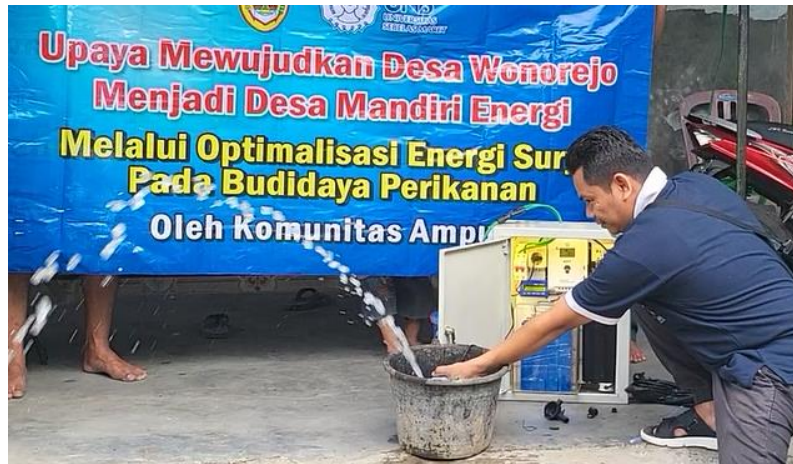
Gambar 6. Ujicoba PLTS offgrid digunakan untuk menggerakkan mesin pompa air.
