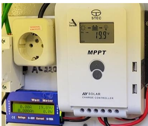
Gambar 5. Tampilan Solar Charge Controller untuk deteksi suplay Panel Surya
