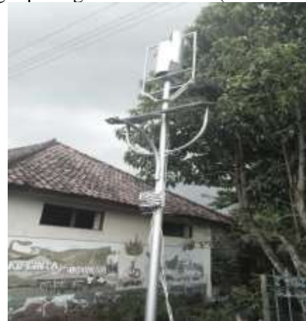
Gambar 2 : Instalasi Panel Surya dan Turbin Angin SD N Ngreden 1 Klaten
