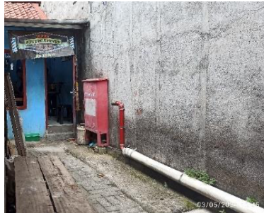
Gambar 14. Proteksi Kebakaran Kotak Hidran di RW 1 Kelurahan Mojo
