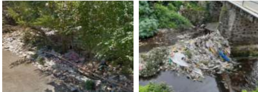
Gambar 12. Kondisi Saluran Drainase yang Tersumbat Sampah
