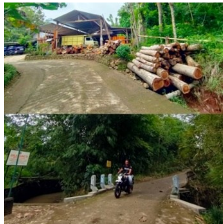
Gambar 7. Kondisi Jalan di Desa Wisata Sumberbulu (Sumber : Olahan Peneliti, 2025)
