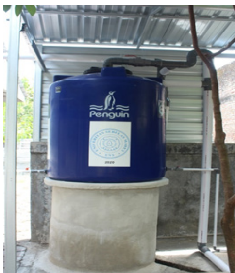
Gambar 11 Alat Pemanen Air Hujan (PAH) yang sudah terpasang
