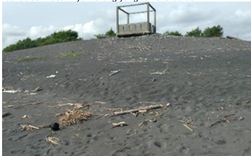
Gambar 3 . Kerusakan Bangunan Barat Pantai Glagah Kulonprogo
