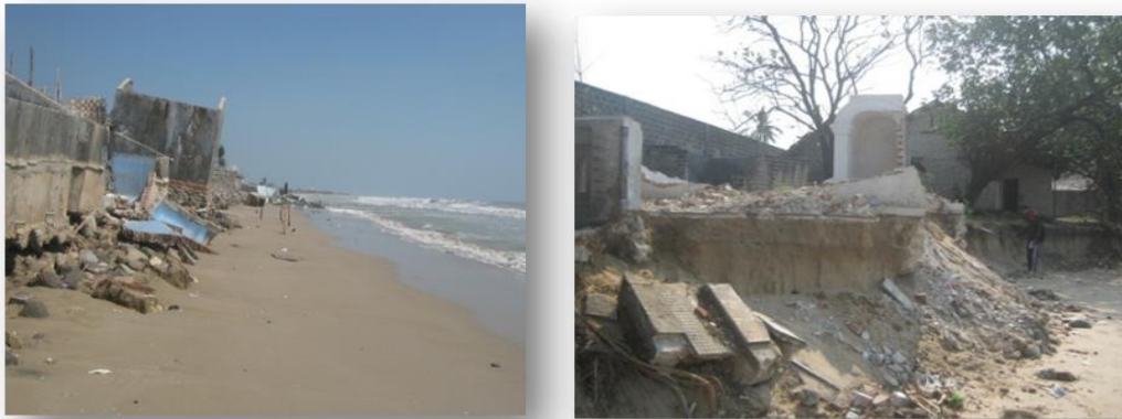
Gambar 1. Pabrik Tambak Udang dan Masjid yang Rusak Akibat Abrasi di Rembang
