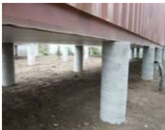
Gambar 10. Pondasi umpak pada bangunan kontainer (sumber: homeinbox.blogspot.com)
