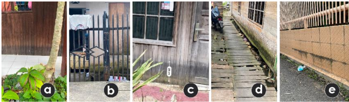
Gambar 10. Bukti Banjir Rob pada Awal 2021 Sumber : Survei, 2023
