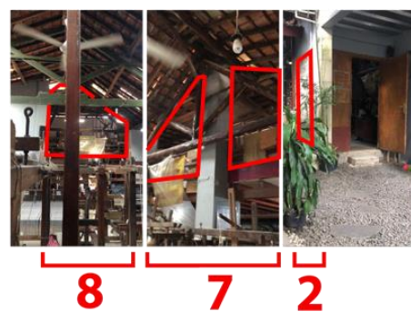
Gambar 8. Kondisi Bukaan Barat Lantai 1
