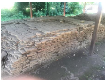
Gambar 11. Kondisi dinding Benteng Somba Opu yang tersisa (Dokumentasi Pribadi, 2020)
