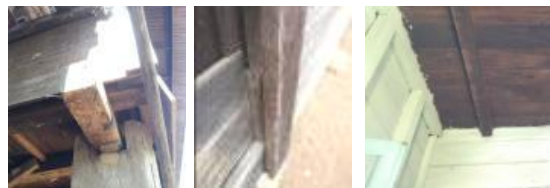
Gambar 7. (kiri atas) Coakan pada kolom-balok sloof ;(kanan atas) sambungan lidah pada dinding; (bawah) sambungan jepit antara kolom-dinding
