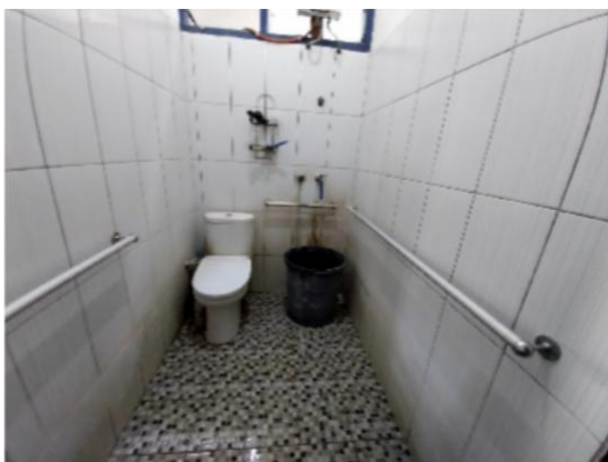
Gambar 4. Handrail Kamar Mandi yang Tidak Sesuai Standar Ketinggian
