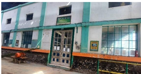
Gambar 12. Pintu Utama Area Kantor dengan Kusen dan Daun Pintu Kayu, Permukaan Cat Pudar dan Kusam, namun Struktur Kayu Masih Layak Dipertahankan dengan Perbaikan Minor
